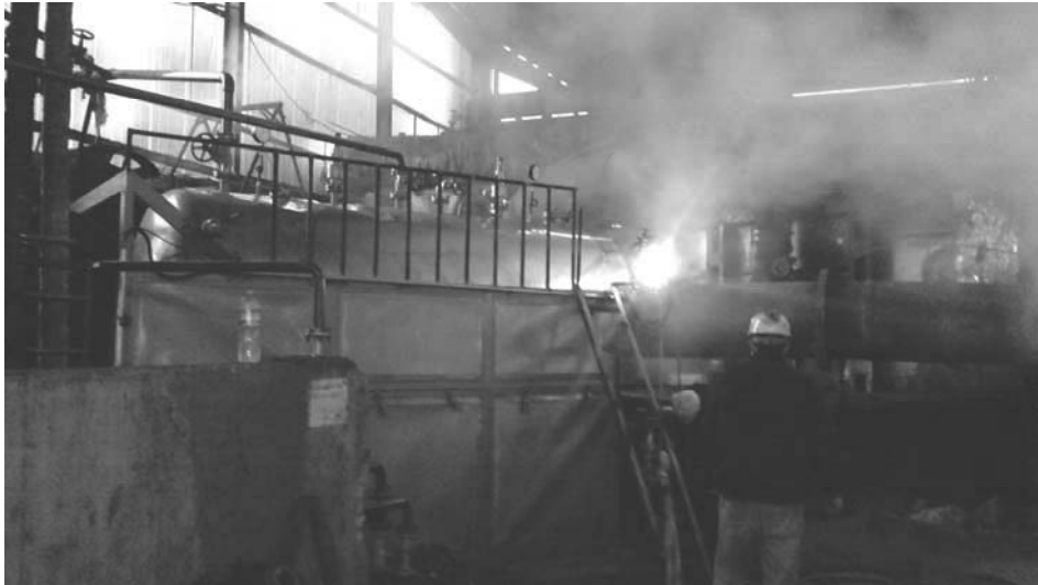
图 12 余热锅炉现场照片
