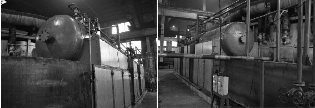
图 10 2#炉余热锅炉现场照片
