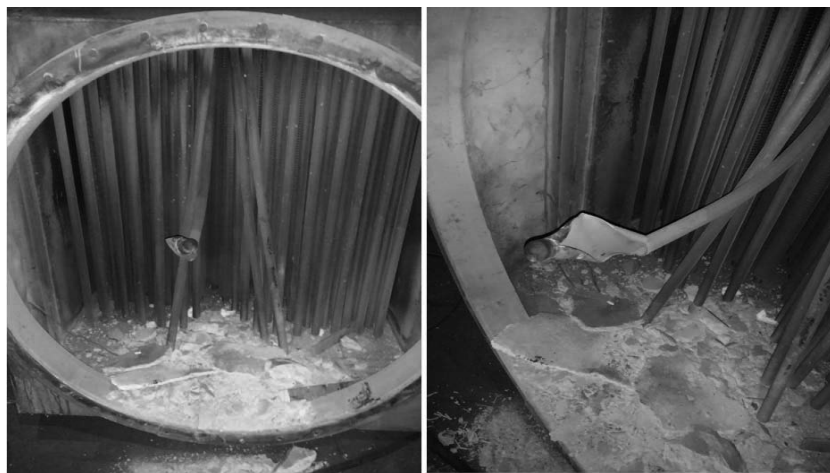
图5 单支形式热管锅炉爆管现场
