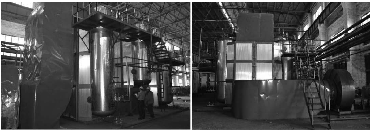
图 11 3#炉余热锅炉现场照片
